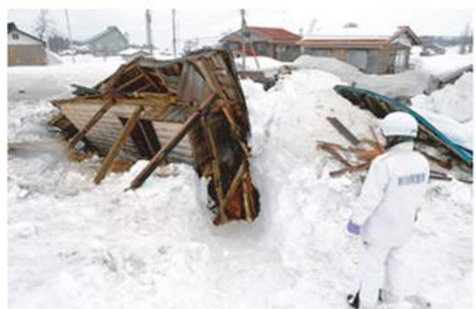
住宅倒壊状況 新潟日報 HP より
